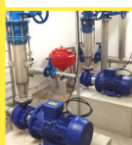
Station de pompage Breuil à Vif - 2021
